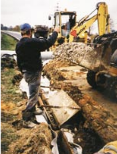
Fot. 10. Odwodnienie (drenaż „francuski”) w pasie rozdzielu w ciągu drogi ekspresowej S-1. Zastosowano kwalifikowane geowłókniny.
