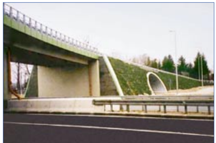
Fot. 5. Skrzyżowanie DK-8 z drogą powiatową Grodzisk Mazowiecki – Żabia Wola. Zastosowano kwalifikowane GPwRW.
