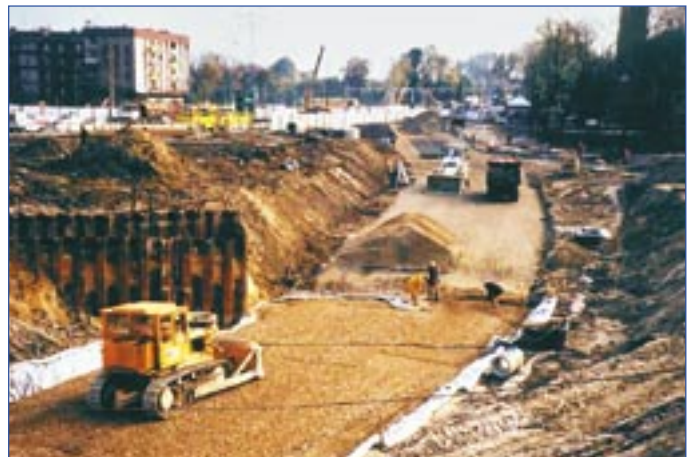
Fot. 4. Przełożenie południowej jezdni ul. Chorzowskiej w ciągu DK-79 w Katowicach pod estakadą DTS. Zastosowano kwalifikowane GPwRW.
