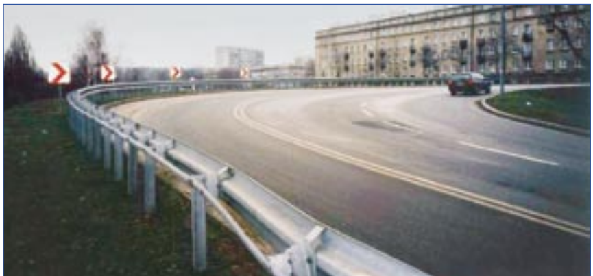
Fot. 11. Drogowa Trasa Średnicowa, ul. Stęślickiego w Katowicach. Na tym obiekcie zamieniono kwalifikowane GPwRW na niekwalifikowane. Zamiast zaprojektowanych materiałów (wykonanych z PVA, o wytrzymałości Fk=250 kN/m, ε=6%) zastosowano geosiatki wykonane z PES o Fk=80 kN/m i ε na poziomie 13%±2,5%! Zagadką jest, po jakim czasie wystąpią pierwsze objawy „plynięcia” zbrojenia?
