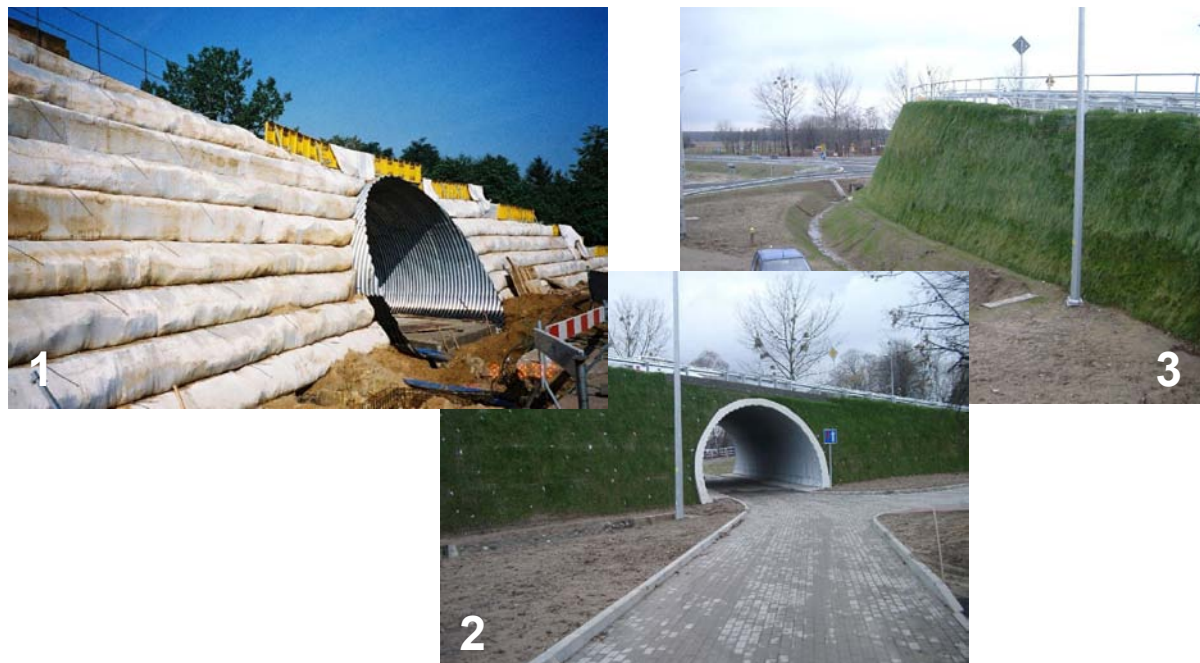
Fot. 1 Połączenie warstw zbrojenia nasypu z przepustem drogowym w trakcie wykonywanych prac.
